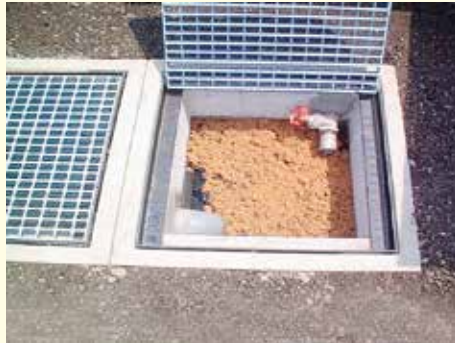
舗装プラント油水分離槽
