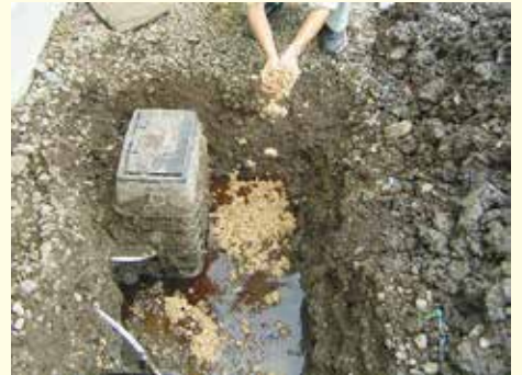
タンクからの灯油流出
