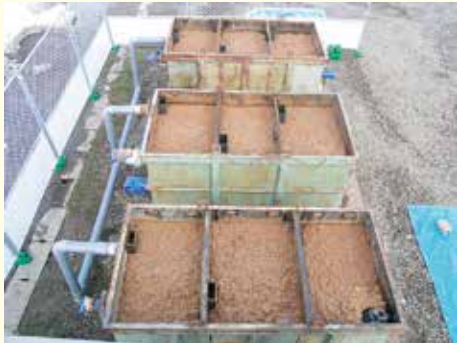
灯油流出事故現場油水分離槽
